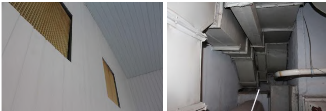
Мал. 8 – Компоненти системи вентиляції
