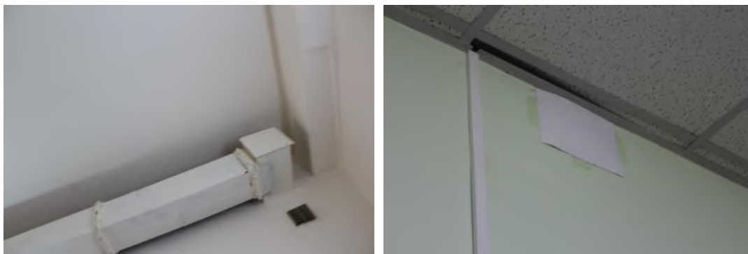
Мал. 8 – Компоненти системи вентиляції
